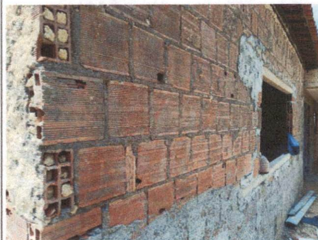
Foto 6: Vergas e contra vergas, Salas de aula 3 e 4. Comprova os itens 2.2.6, 2.2.7 e 3.27.
