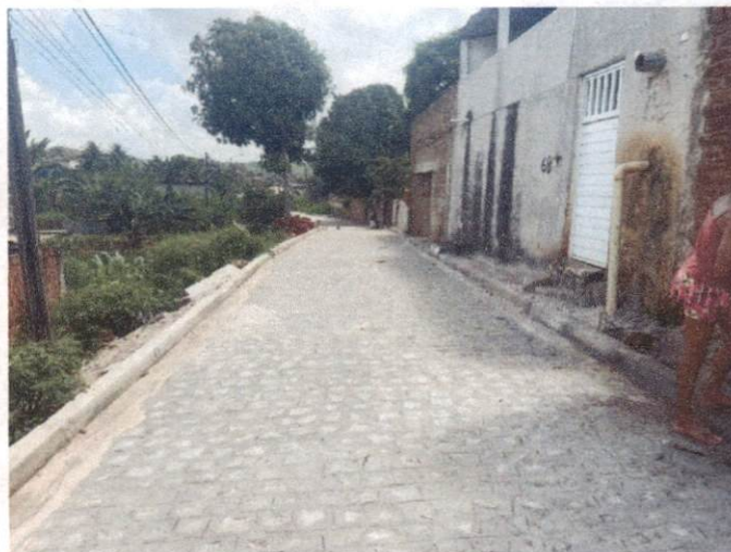
Descrição: RUA AMÉLIA FERREIRA CAVALCANTE (PRIMAVERA) ITEM 1.4.1 - EXECUÇÃO DE PAVIMENTO EM PARALELEPIPEDOS.
