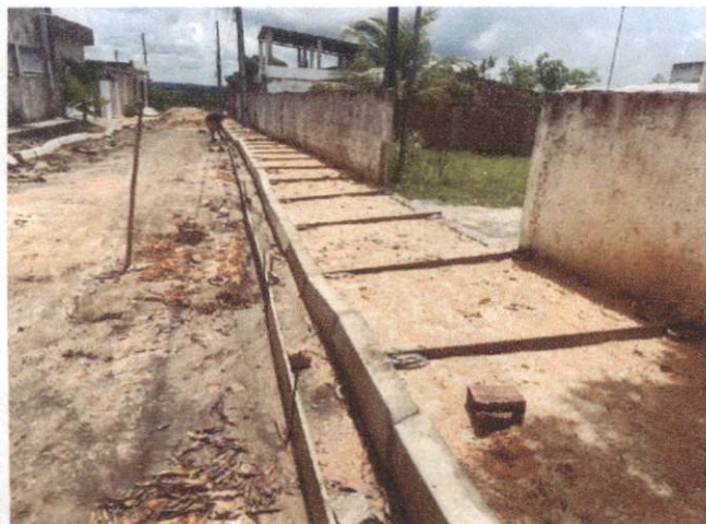
Descrição: RUA ANTÔNIO LOPES (GUADALAJARA): - ITEM 1.5.2 - ATERRO MANUAL DE VALAS COM SOLO ARGILO-ARENOSO E COMPACTAÇÃO MECANIZADA. AF_05/2016
