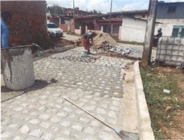
Descrição: RUA AMÉLIA FERREIRA CAVALCANTE (PRIMAVERA) ITEM 1.4.1 - EXECUÇÃO DE PAVIMENTO EM PARALELEPIPEDOS.
