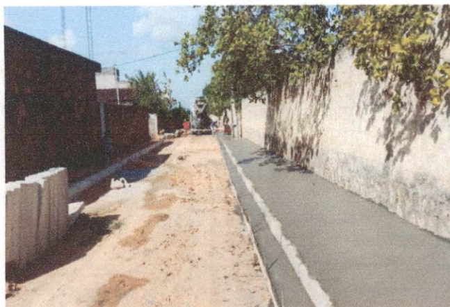
Descrição: RUA ANTÔNIO LOPES (GUADALAJARA): – 1.4.1 ITEM 1.4.3 - EXECUÇÃO DE SARJETA DE CONCRETO ITEM 1.5.3 - EXECUÇÃO DE PASSEIO (CALÇADA)
