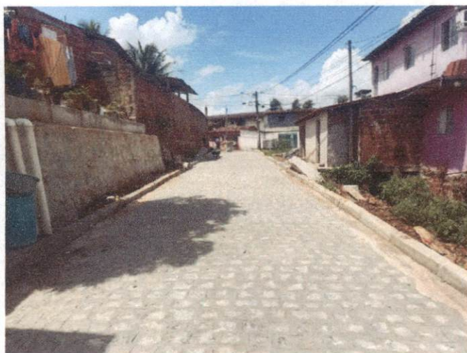
Descrição: RUA AMÉLIA FERREIRA CAVALCANTE (PRIMAVERA) ITEM 1.4.1 - EXECUÇÃO DE PAVIMENTO EM PARALELEPIPEDOS.
