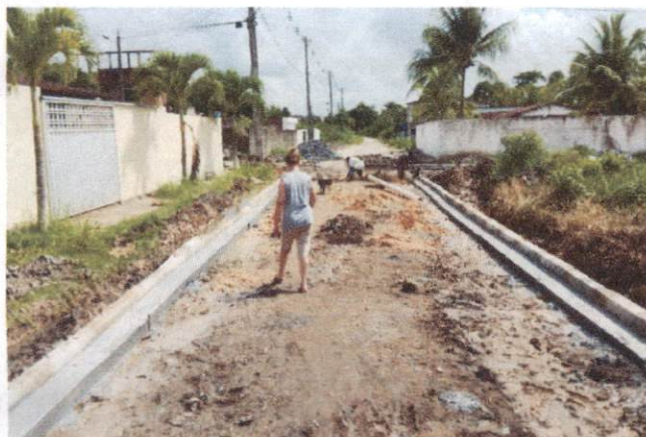
Descrição: AVENIDA DO CANAL ( PRIMAVERA ) – ITEM 1.4.2 - ASSENTAMENTO DE GUIA (MEIO-FIO); ITEM 1.4.3 - EXECUÇÃO DE SARJETA DE CONCRETO
