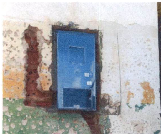
Foto 26: Caixa do medidor de energia. Comprova o item 9.1.
