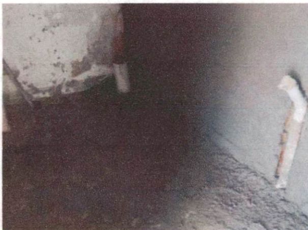
Foto 23: Pontos hidrossanitário. Comprova os itens 7.2 e 7.3.
