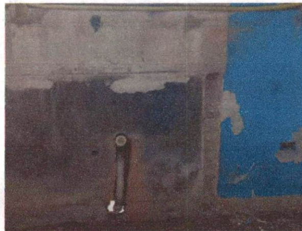
Foto 24: Pontos hidrossanitário. Comprova os itens 7.2 e 7.3.
