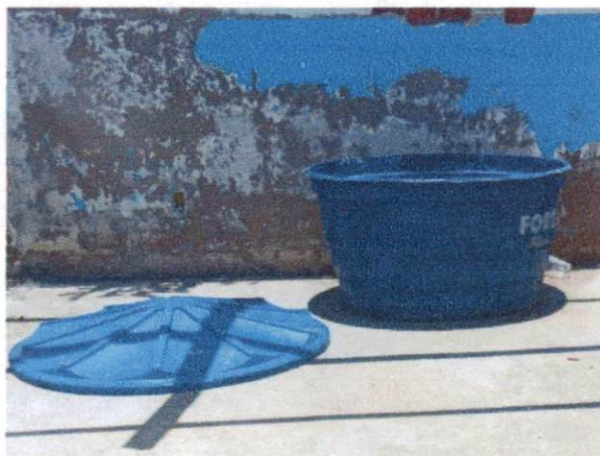
Foto 25: Caixa d'água. Comprova o item 7.5.
