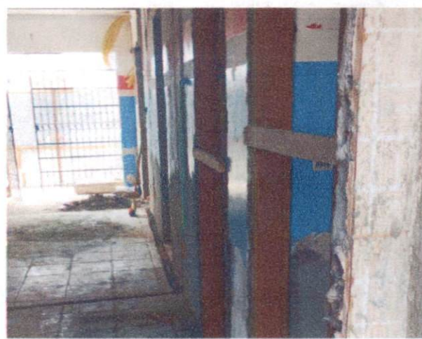
Foto 10: Remoção e de portas e grades e instalação de novas molduras das portas. Comprova o item 1.5.
