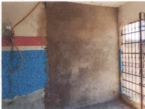
Foto 21: Chapisco, emboço. Comprova o item 2.3.
