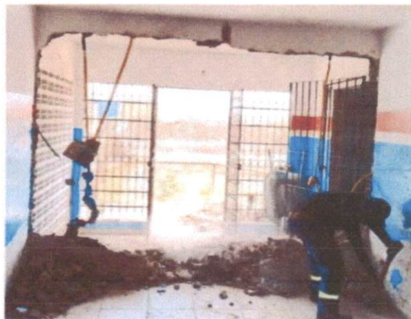
ITEM: 2.3 DEMOLIÇÃO DE ALVENARIA DE BLOCO FURADO, DE FORMA MANUAL, SEM REAPROVEITAMENTO. AF_12/2017 CRAS PRIMAVERA
