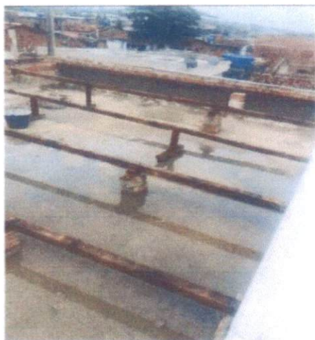
ITEM: 2.1 REMOÇÃO DE TELHAS, DE FIBROCIMENTO, METÁLICA E CERÂMICA, DE FORMA MANUAL, SEM REAPROVEITAMENTO. AF_12/2017 CRAS PRIMAVERA
