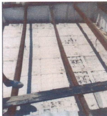
ITEM: 2.1 REMOÇÃO DE TELHAS, DE FIBROCIMENTO, METÁLICA E CERÂMICA, DE FORMA MANUAL, SEM REAPROVEITAMENTO. AF_12/2017 CRAS PRIMAVERA
