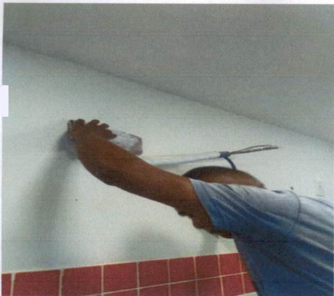
Item : 8.9 APLICAÇÃO E LIXAMENTO DE MASSA LÁTEX EM PAREDES, DUAS DEMÃOS. AF_06/2014 UBS ASA BRANCA
