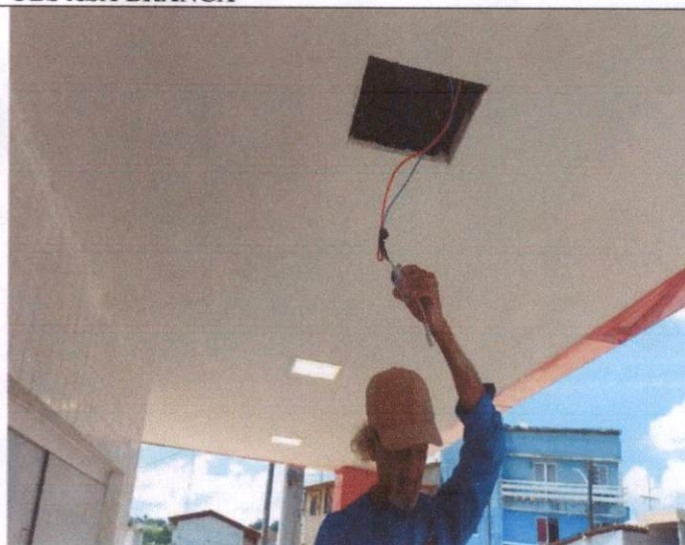
Item: 7.31 REATOR LED DRIVER 24W FORNECIMENTO E INSTALAÇÃO UBS PRIMAVERA II
