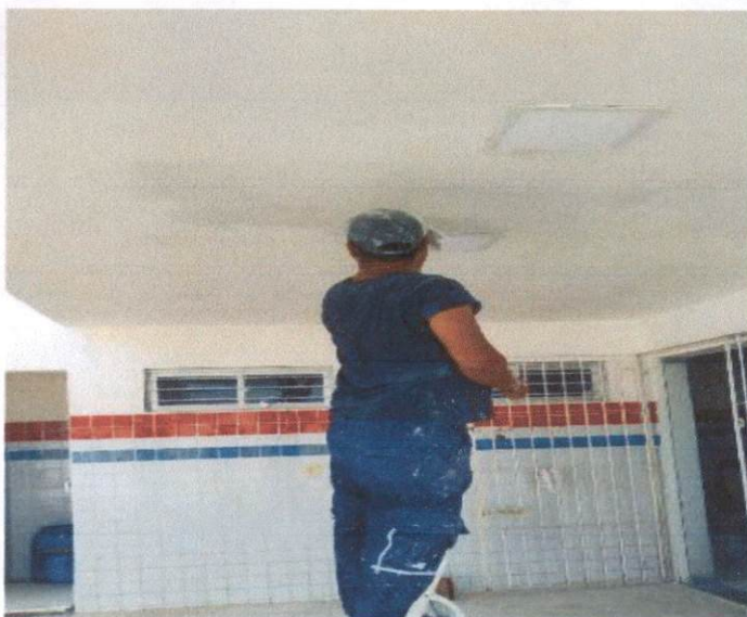
Item: 8.5 APLICAÇÃO E LIXAMENTO DE MASSA LATEX EM TETO, DUAS DEMÃOS. AF_06/2014 UBS ASA BRANCA
