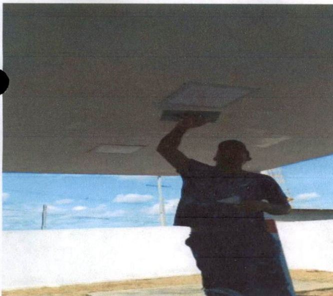
Item: 8.5 APLICAÇÃO E LIXAMENTO DE MASSA LATEX EM TETO, DUAS DEMÃOS. AF_06/2014 UBS ASA BRANCA
