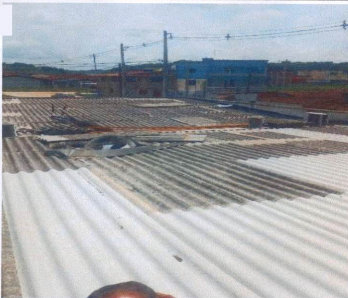
Item: 5.2 TELHAMENTO COM TELHA ONDULADA DE FIBROCIMENTO E = 6 MM, COM RECOBRIMENTO LATERAL DE 1/4 DE ONDA PARA TELHADO COM INCLINAÇÃO MAIOR QUE 10°, COM ATÉ 2 ÁGUAS, INCLUSO ICAMENTO. AF 07/2019 UBS ASA BRANCA
