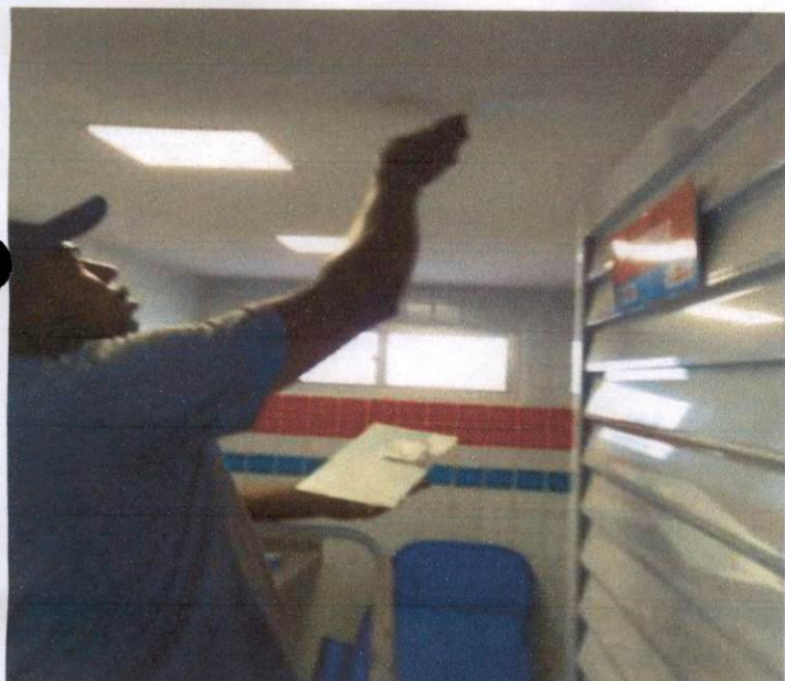
Item: 7.6 LUMINÁRIA LED 30X30CM DE SOBREPOR DE 24W - FORNECIMENTO E INSTALAÇÃO UBS ASA BRANCA
