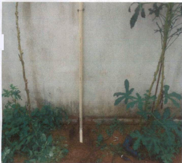
Item: 6.28 TUBO PVC, SERIE NORMAL, ESGOTO PREDIAL, DN 40 MM, FORNECIDO E INSTALADO EM RAMAL DE DESCARGA OU RAMAL DE ESGOTO SANITÁRIO. 6.29 JOELHO 90 GRAUS, PVC, SERIE NORMAL, ESGOTO PREDIAL, DN 40 MM UBS ASA BRANCA
