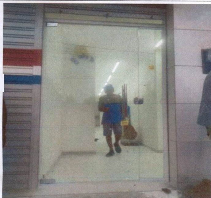
Item: 4.13 PORTA DE ABRIR COM MOLA HIDRAULICA, EM VIDRO TEMPERADO, 90X210 CM, ESPESSURA 10 MM, INCLUSIVE ACESSÓRIOS. Item 4.14 INSTALAÇÃO DE VIDRO TEMPERADO, E = 10 MM, ENCAIXADO EM PERFIL U. AF 01/2021 UBS PRIMAVERA II
