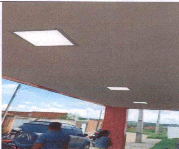
Item: 7.6 LUMINARIA LED 30X30CM DE SOBREPOR DE 24W - FORNECIMENTO E INSTALAÇÃO UBS ASA BRANCA
