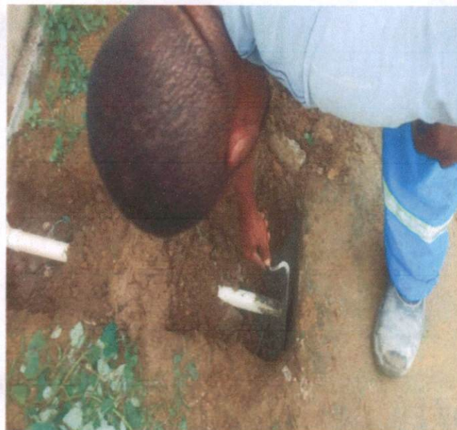
Item: 6.28 TUBO PVC, SERIE NORMAL, ESGOTO PREDIAL, DN 40 MM, FORNECIDO E INSTALADO EM RAMAL DE DESCARGA OU RAMAL DE ESGOTO SANITÁRIO. AF 12/2014 UBS ASA BRANCA
