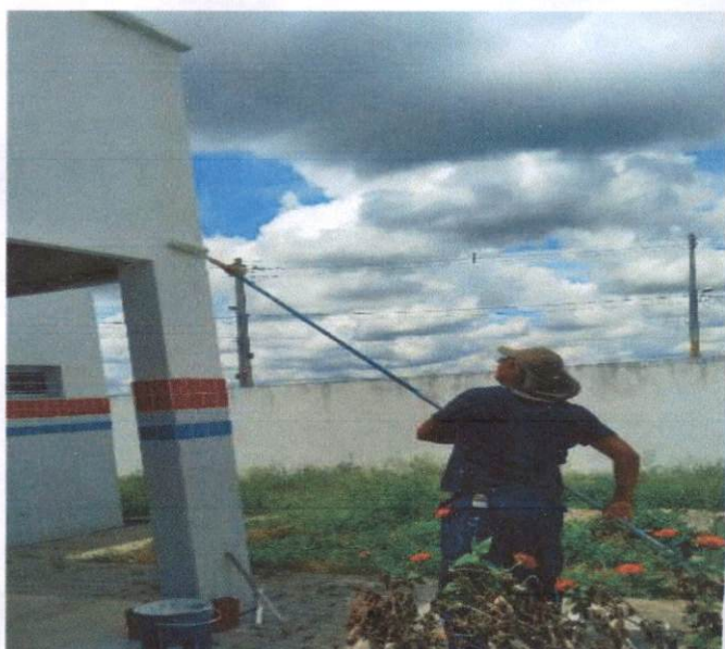
Item: 8.11 APLICAÇÃO MANUAL DE TINTA LÁTEX ACRÍLICA EM PAREDE EXTERNAS DE CASAS, DUAS DEMÃOS. AF 11/2016
