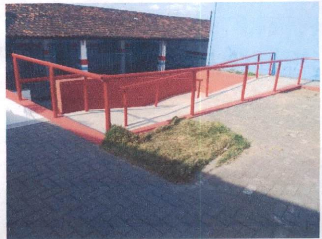
Foto 44: Pintura a óleo (item 1.2) e Pintura látex em paredes externas (item 1.3) na Escola Municipal Manoel da Rosa
