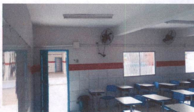
Foto 2: Pintura látex em paredes internas (item 1.1) e pintura a óleo (item 1.2) na Escola Municipal de Paudalho (CMP).
