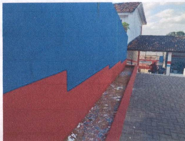
Foto 48: Pintura látex em paredes externas (Item 1.3) na Escola Municipal Manoel da Rosa
