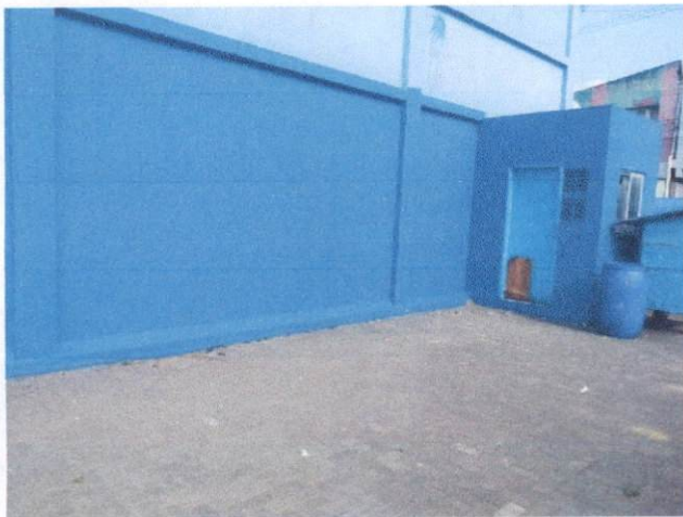
Foto 49: Pintura látex em paredes externas (Item 1.3) na Escola Municipal Manoel da Rosa
