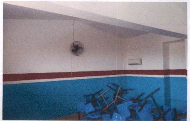
Foto 14: Pintura látex em paredes internas (item 1.1) e pintura a óleo (item 1.2) na Escola Municipal Tancredo Neves
