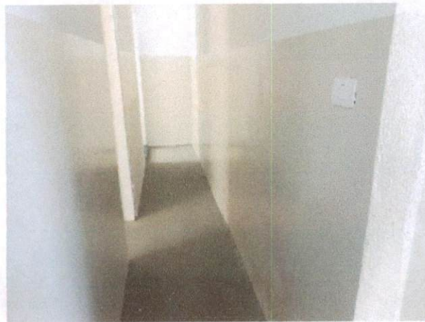
Foto 54: Pintura látex em paredes internas (item 1.1) e pintura a óleo (item 1.2) no CEDECOP
