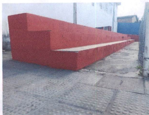
Foto 40: Pintura látex em paredes externas (Item 1.3) na Escola Municipal Manoel da Rosa
