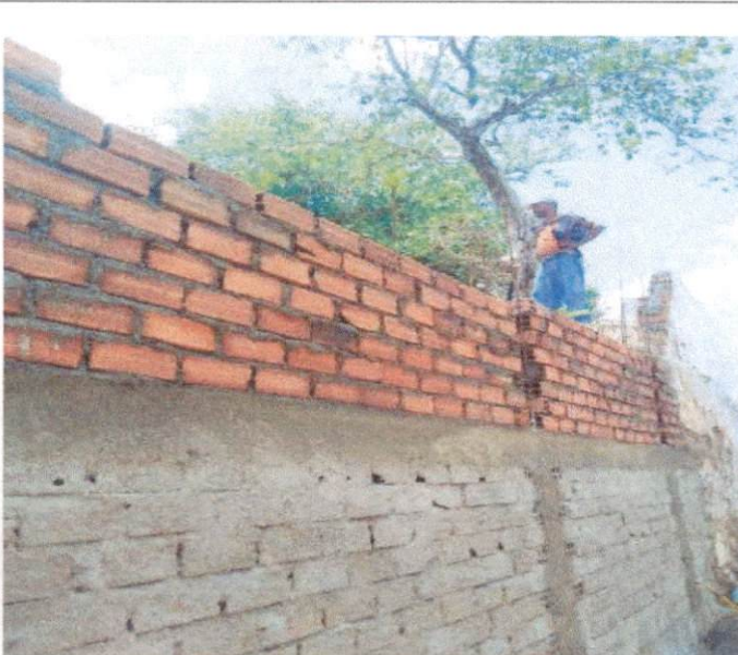
Item: 4.1 CHAPISCO APLICADO EM ALVENARIA E ESTRUTURAS DE CONCRETO INTERNAS, COM COLHER DE PEDREIRO, ARGAMASSA TRAÇO 1:3 COM PREPARO MANUAL
