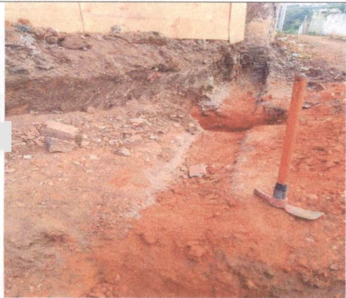
Item: 2.21 ESCAVAÇÃO MANUAL DE VALA COM PROFUNDIDADE MENOR OU IGUAL A 1,30 M. AF_02/2021
