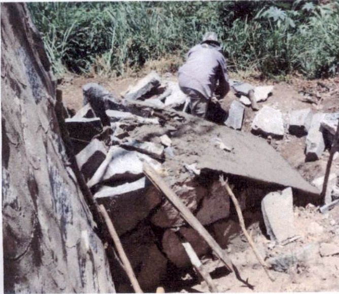
Item: 3.10 MURO DE ARRIMO DE ALVENARIA DE PEDRA ARGAMASSADA TRAVAMENTO DO MURO
