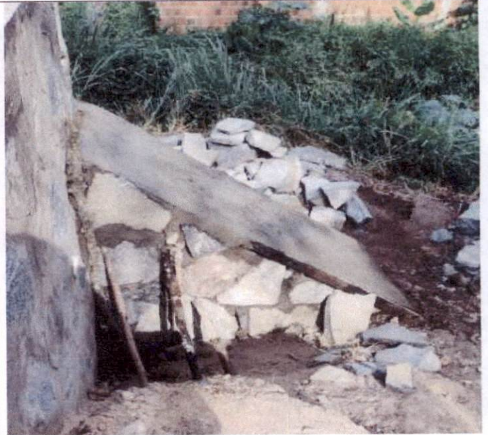
Item: 3.10 MURO DE ARRIMO DE ALVENARIA DE PEDRA ARGAMASSADA TRAVAMENTO DO MURO
